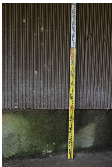
写真1 町営駐車場における冠水の痕跡
