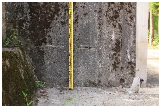
写真2 町営第2駐車場付近の可動式防水壁周辺に残る冠水の痕跡
