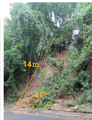
写真-8 斜面崩壊 (⑥)
