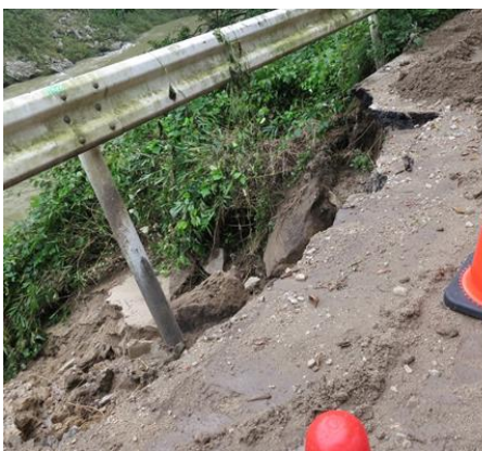
写真-6 道路陥没 (④)
