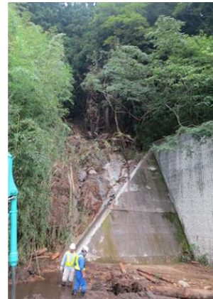
写真-5 斜面崩壊 (③)
